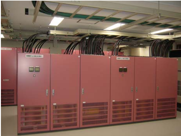
図 2 . 無停電電源装置
